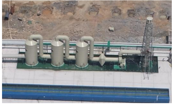
M13废气治理设施-酸液吸收塔
